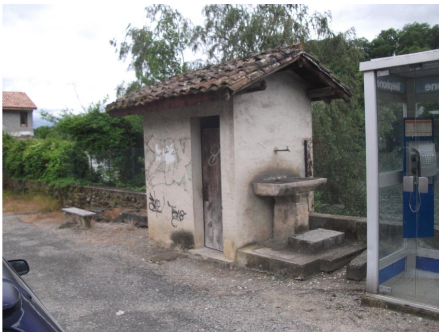
Photographie 53 : Le parking nécessite d'être réaménagé
